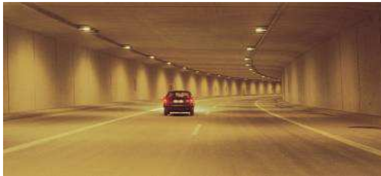
Figura 3.2. Túnel iluminado con lámparas de vapor de sodio alta presión.
