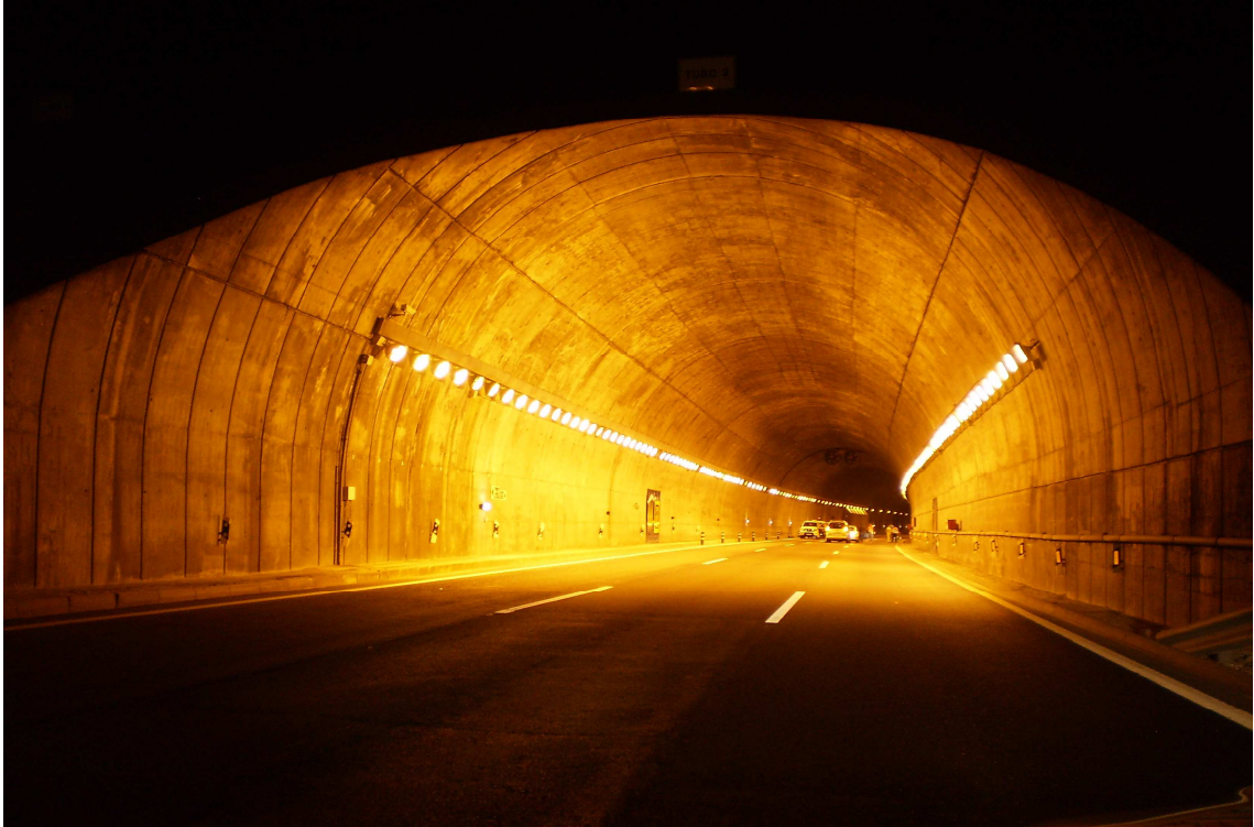
Fotografía 1. Túnel de Somosierra. Iluminación con VSAP. Boca norte (sentido de la marcha) con todo el alumbrado encendido.
