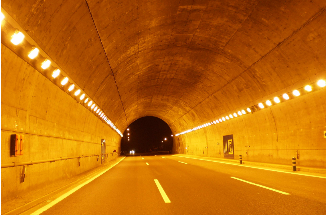
Fotografía 3. Túnel de Somosierra. Iluminación con VSAP. Boca norte (sentido contrario al de la marcha) con todo el alumbrado encendido.
